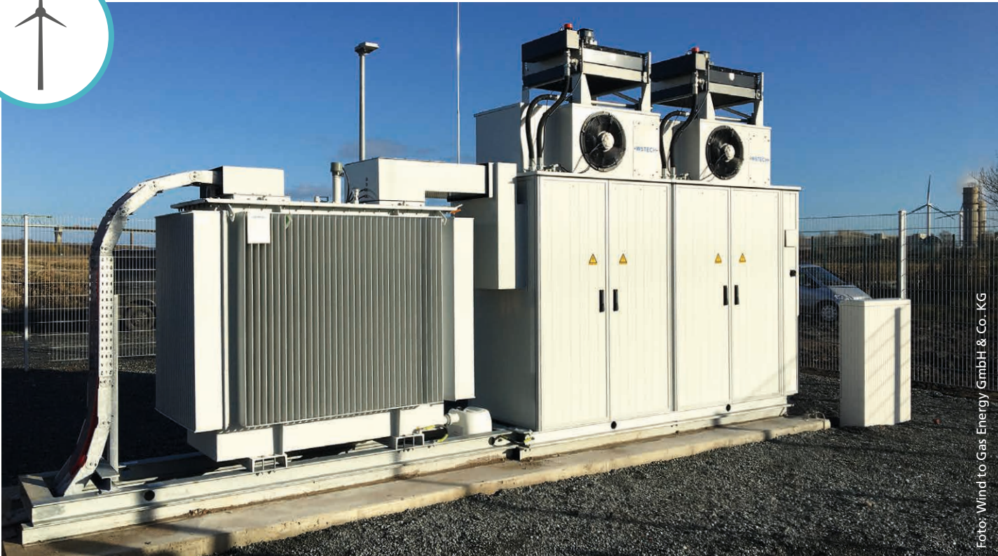
Batteriespeicherkraftwerk, Wind to Gas Energy
