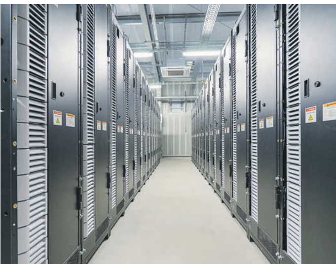
Hightech auf engstem Raum: Batteriesystem in Jardelund
